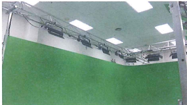
Fotografía 2 Croma y estructura de luminarias
