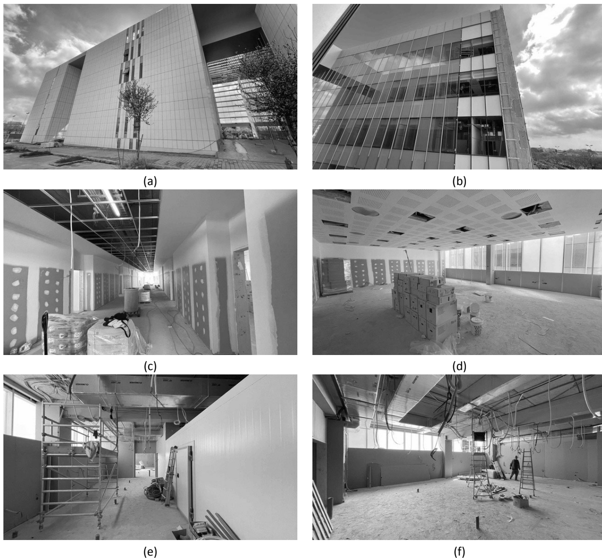
Figura 44: Estado de las obras de la Facultad de Ciencias de la Salud en febrero de 2022. (a) y (b) Exterior. (c) y (d) Pasillos y aulas del módulo docente. (e) y (f) Espacios de la sala de disección.
